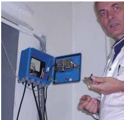
Fig.3: Installazione temporanea del sistema di CM online VIBNODE®
